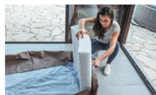
Structure isolante en mousse (épaisseur 13 cm)
